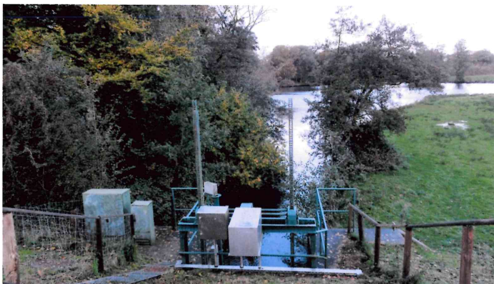
Abbildung 4-2: Sielzulauf mit automatischer Schiebersteuerung
