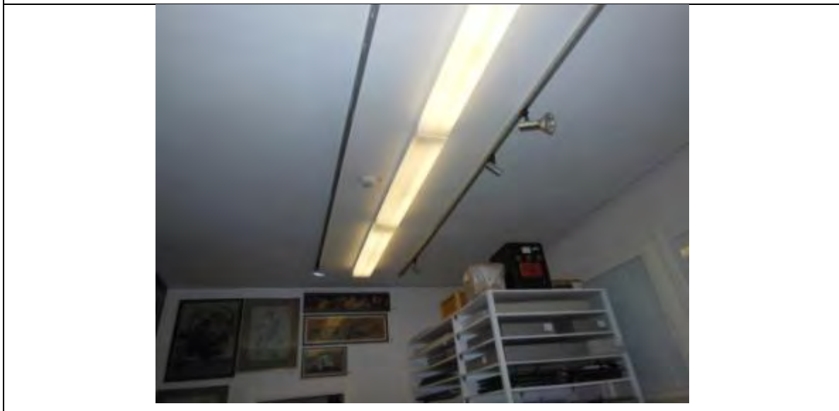
Ineffiziente Beleuchtung: Die Leuchtstofflampen sind nicht verspiegelt und haben veraltete Vorschaltgeräte.
