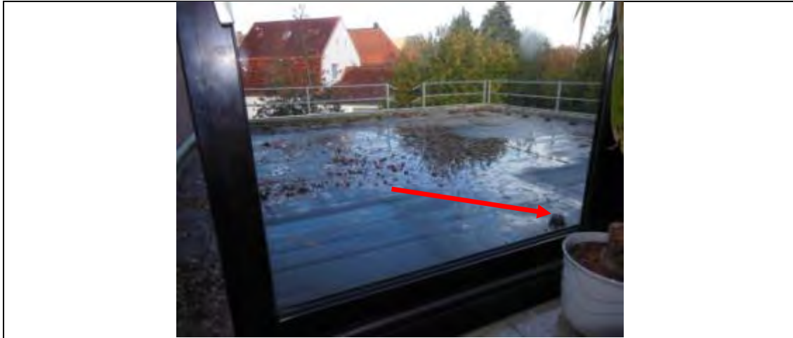
Flachdach auf der Hauptschule; Regenwasser sollte durch das innenliegende Fallrohr (Pfeil) abfließen. Das Regenrohr stellt eine massive Wärmebrücke dar.
