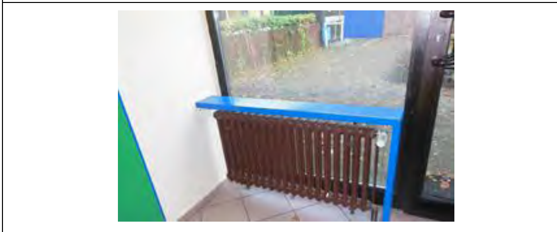
Heizkörper vor ungedämmtem Fenster. Zwischen Heizkörper und Fenster sollte eine Dämmplatte angebracht werden.
