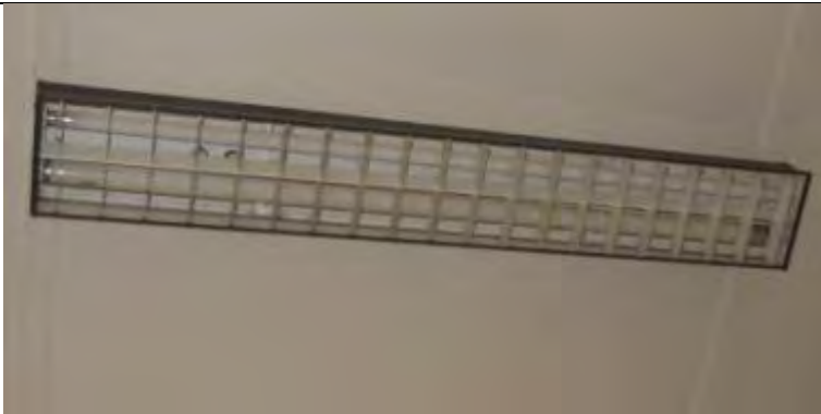
Ineffiziente Leuchten ohne Reflektor und mit veralteten konventionellen Vorschaltgeräten (KVG).
