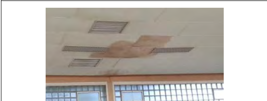
Das Dach in der Sporthalle ist mangelhaft gedämmt und undicht.
