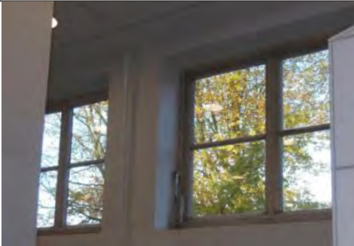
Undichte Fenster, mangelhafter Wärmeschutz
