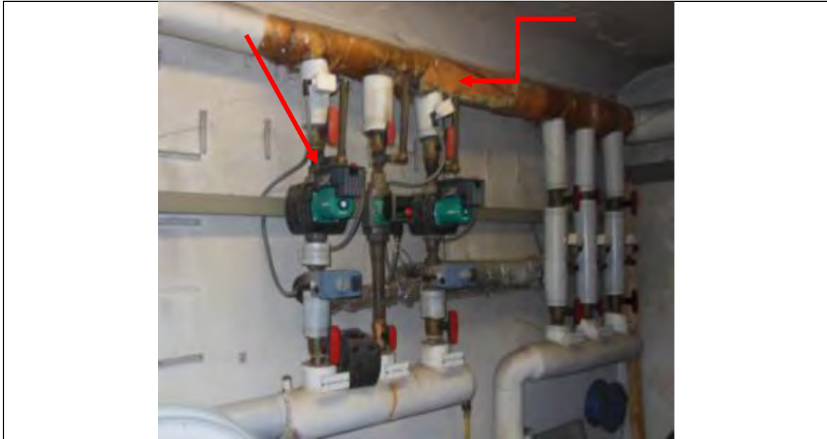
Lückenhaft gedämmte Leitungen, Verteilerrohre sind zu dünn gedämmt.
